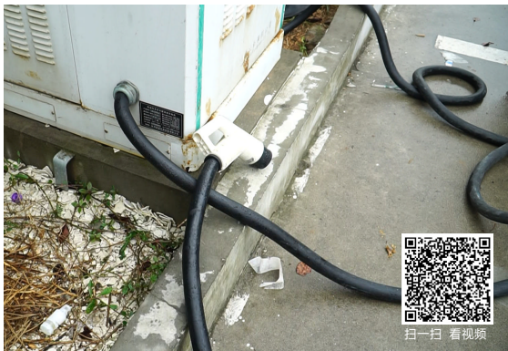
岱山高亭南吞停车场，充电桩存在脏污和破损的问题
