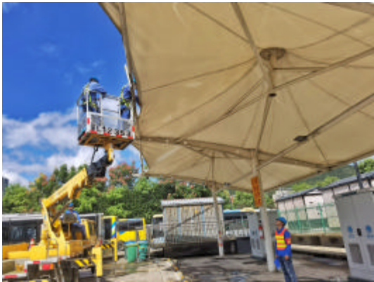
启明集团新能源充电站建设
