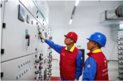
2021年6月，启明制造公司员工对新城宝龙广场配电房进行设备检查
