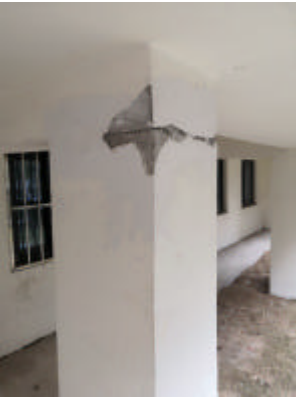
被汽车撞出一道裂缝的外墙墩柱
